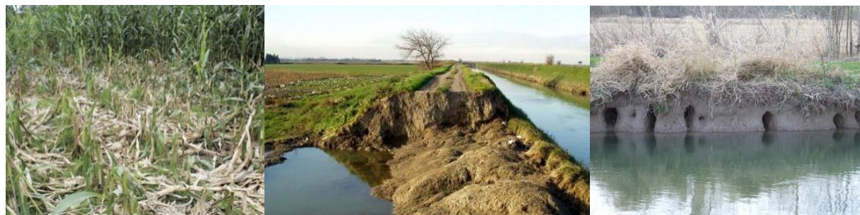
Figure 32: Exemple de dégâts causés par les ragondins
